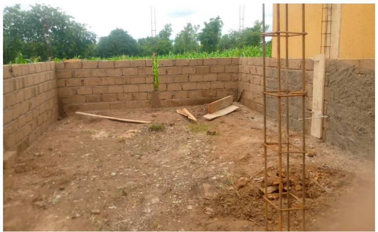
De buitenmuren staan overeind
